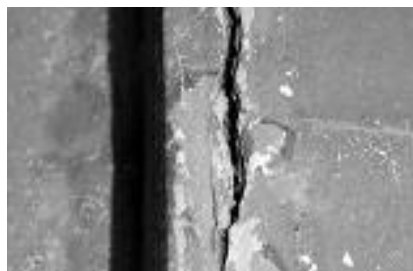
Fot. 2. Pęknięcie zmęczeniowe w obrębie niewłaściwego połączenia żebra z płaszczem
