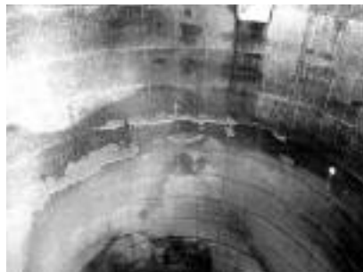
Fot. 5. Widok sadzy i złuszczonego betonu we wnętrzu silosu [2]
