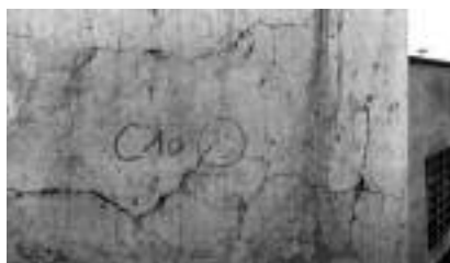
Fot. 1. Zarysowania betonu od zewnątrz silosu [2]
