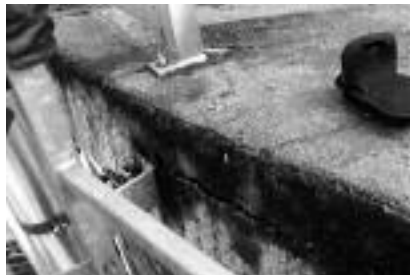
Fot. 2. Zarysowania i spękania betonu górnej płyty silosu oraz brak obróbek blacharskich [2]
