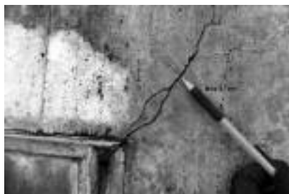
Fot. 3. Rysy ukośne naroży otworów na zewnętrznej stronie ścian silosu [2]
