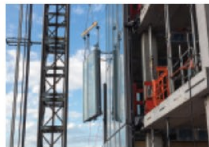
Fot. 2. Siedziba Europejskiego Banku Centralnego ECB we Frankfurcie nad Menem – montaż paneli elewacyjnych do konstrukcji nośnej budynku
