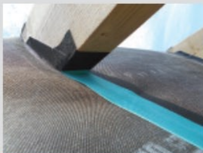
Fot. 8. Ten sam dach co na fotografiach 7 i 9. Kolejny etap uszczelniania krokwi po stronie zewnętrznej budynku. Naciętą membranę pod krokwią sklejo grubszą taśmą (zieloną), zaś belki oklejo taśmą cieńszą bardziej elastyczną (czarna)
