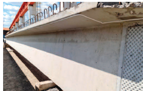
Fot. 2. Przebarwienia na powierzchni betonu powstałe w wyniku zaschnięcia zaczynu na formie
