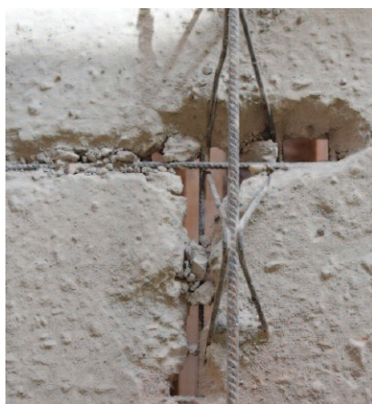
Fot. 2. Uszkodzony fragment płyty prefabrykowanej Filigran Photo 2. Damaged part of the precast Filigran slab
