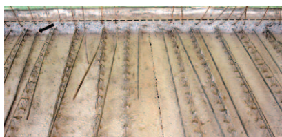
Fot. 4. Wadliwie (zbyt nisko) zamontowane zbrojenie górne
