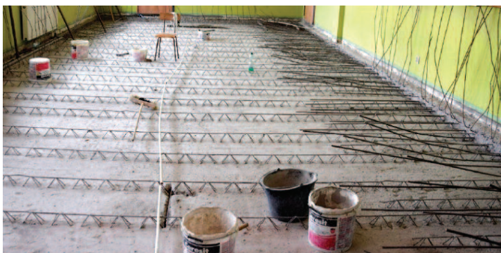
Fot. 1. Strop korytarza z usuniętą warstwą nadbetonu Photo 1. The ceiling of the corridor without concrete topping
