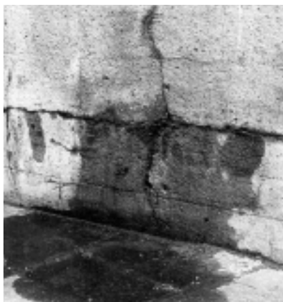
Fot. 3. Przecieki przez przerwę roboczą
