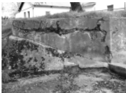
Fot. 1. Spękania betonu od korzeni drzew
