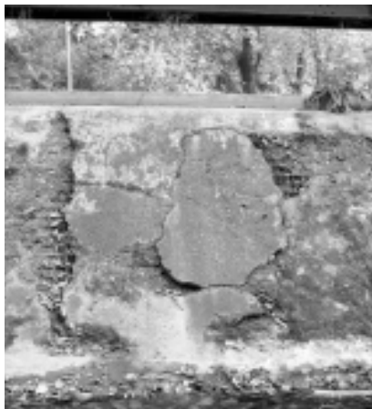
Fot. 2. Uszkodzona otulina (odsłonięte zbrojenie)
