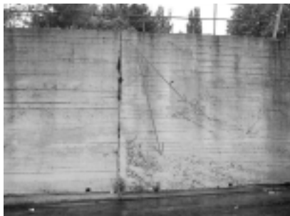
Fot. 4. Błędy przy układaniu betonu
