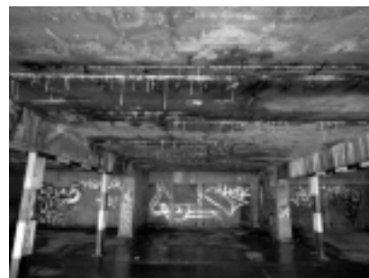
Fot. 3. Przecieki na złączach płyt kanałowych
