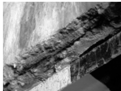
Fot. 2. Korozja prętów zbrojeniowych
