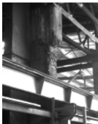
Fot. 3. Ingerencja (podcięcie) w konstrukcję słupa
