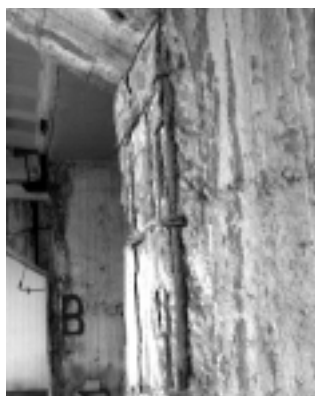
Fot. 2. Odspojona otulina i skorodowane zbrojenie słupa
