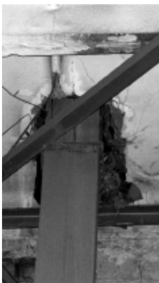
Fot. 4. Niezgodne z zasadami technicznymi przebicie przez płytę
