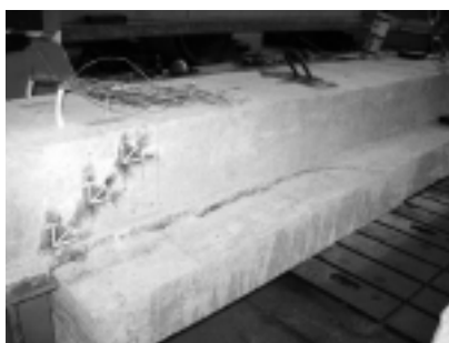
Fot. 5. Zniszczenie wsporników bocznych
