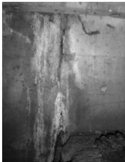
Przykład zarysowania ściany misy
