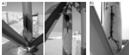
Fot. 1. Pęknięte rury w wieży wysokości: a) 30,0 m; b) 20,0 m
