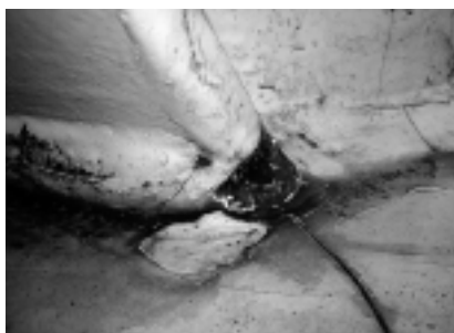
Fot. 2. Nieszczelność (otwór-krater) w spoinie między rurą górnego krawężnika a blachą kołnierkową; widoczne ognisko silnej korozji (pod farbą) i znaczne pęknięcia farby
