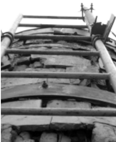
Fot. 2. Uszkodzenia komina 2 przykrytego stalowym deklem
