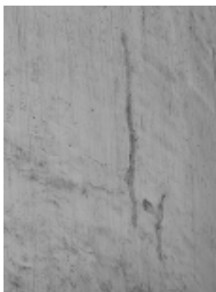
Fot. 1. Przykładowe uszkodzenia
