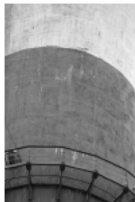
Fot. 1. Wycieki zasady wapniowej
