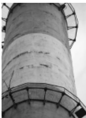
Fot. 2. Widok uszkodzeń na górnej części kominia
