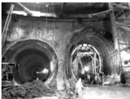
Dwa rodzaje obudów stałych tuneli – po lewej z segmentów żelbetowych, po prawej obudowa monolityczna. Budowa linii C metra w Rzymie [Fot. A. Siemińska-Lewandowska]
