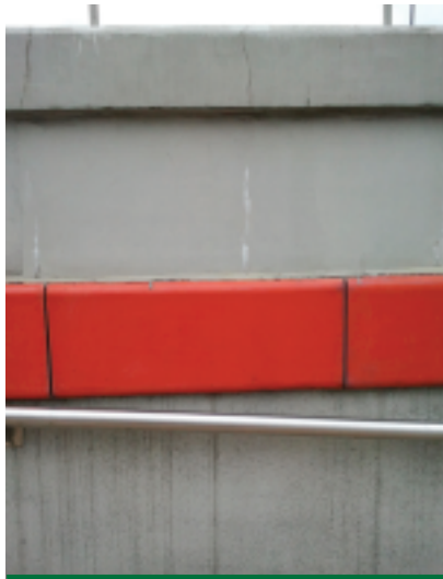
Fot. 1. Na żelbetowej ścianie oporowej, białe naloty powstały w wyniku transportu soli z cementu portlandzkiego
