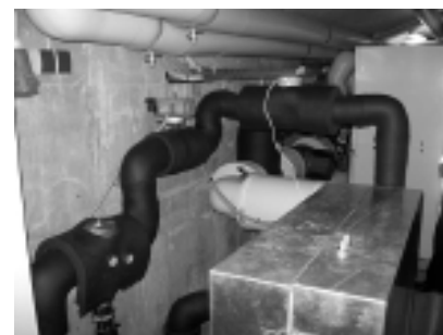
Fot. 4. Stacja pomp ciepła
