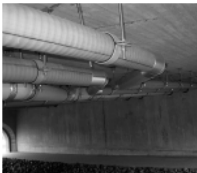
Fot. 3. Instalacja przesyłowa z rur preizolowanych
