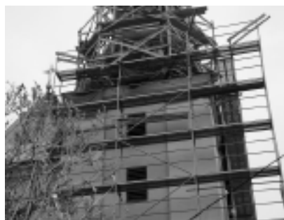
Fot. 4. Nieprawidłowe wykonanie stężenia rusztowania (archiwum firmy PIONART)
