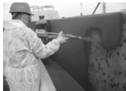
Nakładanie powłoki ochronnej w technologii MC-RIM w Oczyszczalni Ścieków Płaszów II w Krakowie
