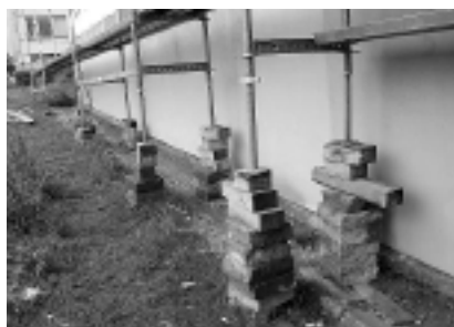
Fot. 2. Nieprawidłowe posadowienia rusztowania (Fot. S. Vlasak)
