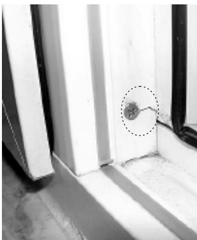
Fot. 8. Rozerwany koniec słupka – uszkodzenie nastąpiło przy skręcaniu słupka z ramą (Fot. Autor)
