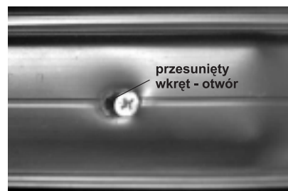
Fot. 11. Od nagrzewania nastąpiło wydłużenie ramy, wkręt stalowy wyciął bruzdę, pozostał duży otwór, przez który może wnikać woda opadowa (jest to górna część okna) (Fot. Autor)
