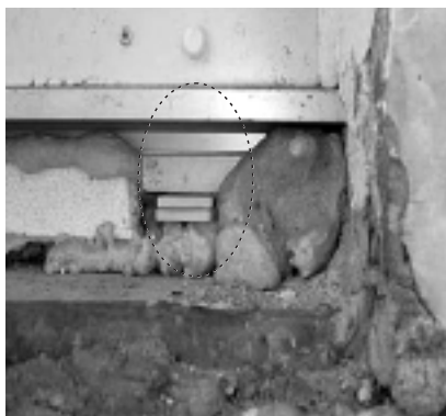
Fot. 15. Klasyczny przykład podparcia okna w narożu (pianka PU, kawałki styropianu, dwie podkładki szklarskie, gruz, puste dziury – pianka wtrąsnięta na nieoczyszczone podłoże) (Archiwum OKNOTEST)
