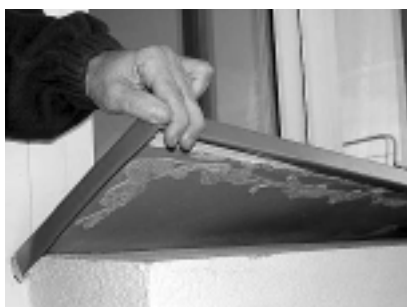
Fot. 14. Luźny parapet zewnętrzny „przyklejony” na silikon; powszechnym błędem jest mocowanie krawędzi parapetów zewnętrznych do ramy okna nitami zrywalnymi, styk zakleja się silikonem – to błąd, (silikon nie ma przyczepności do kształtowników); zasłonięte odwodnienia to dodatkowa wada (Fot. Autor)
