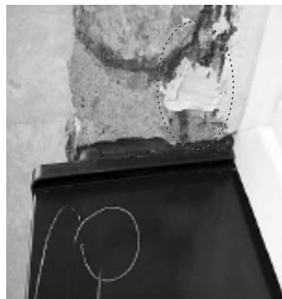
Fot. 19. Zarysowany parapet zewnętrzny, za krótki, szczelina uzupełniona brązowym silikonem, kamienna elewacja wybrudzona gipsem (Archiwum OKNOTEST)
