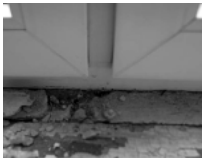
Fot. 18. Okno w progu podlane zaprawą zamiast uszczelnienia; przy opadach spod okna wycieka woda (Fot. Autor)
