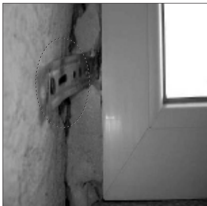
Fot. 13. Kotew przybita do ściany gwoździem (Fot. Autor)
