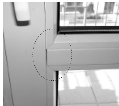
Fot. 21. Za krótka szczelina (rygiel) drzwi balkonowych; zimą przez szczelinę wwiejany jest śnieg (Fot. Autor)
