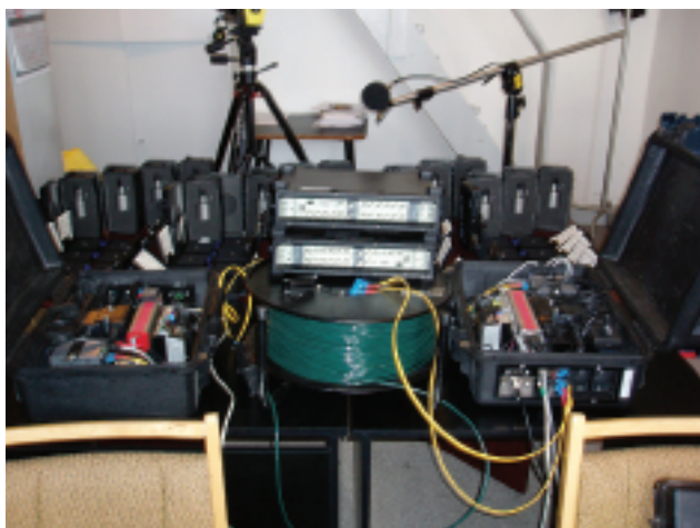
Fot. 2. Dodatkowe stacje zasilające sprzężone linią światłowodową
