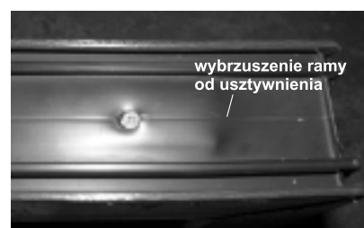
Fot. 10. Szczegół wybruszenia ramy okna od stalowego usztywnienia (Fot. Autor)
