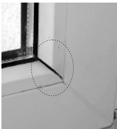
Fot. 6. Za krótka listwa przyszybowana (przez takie szczeliny woda wyruszająca się na szybach wcieka pod szyby, gromadzi się pod nimi i zalega, zimą zamarza) (Fot. Autor)
