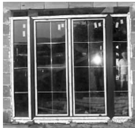
Fot. 20. Podwójne drzwi balkonowe; za niskie w nadprożu; w progu ustawione na warstwie pianki PU i luźno podłożonych kawałkach desek, na bokach na „wcisk”, drzwi praktycznie „wiszą” na piance PU (Archiwum OKNOTEST)
