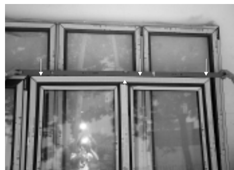
Fot. 9. Odkształcenia górnej ramy ościeżnicy okna dwudzielnego; wybruszenia – nad słupkiem i ok. 15 cm od lewego naroża, wklęśnięcie w środku szerokości skrzydła lewego, opuszczenie w narożach lewym i prawym po ok. 3 – 5 mm; w sumie są to cztery fale – pokazane strzałkami (Fot. Autor)
