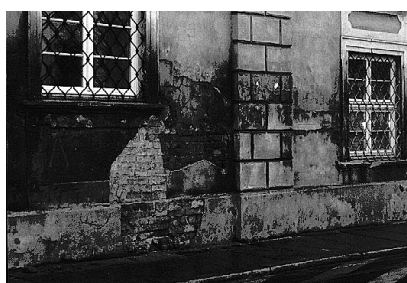
Fot. 2. Gmach Główny Zakładu Narodowego im. Ossolińskich we Wrocławiu. Fragment elewacji zachodniej przed remontem
